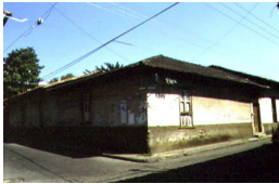
157 de 200 Casa-habitación Inmueble Casa-habitación I-0011604087, Ficha sin clasificación Michoacán de Ocampo, Uruapan, Uruapan Pino Suárez Núm. ext. 74
